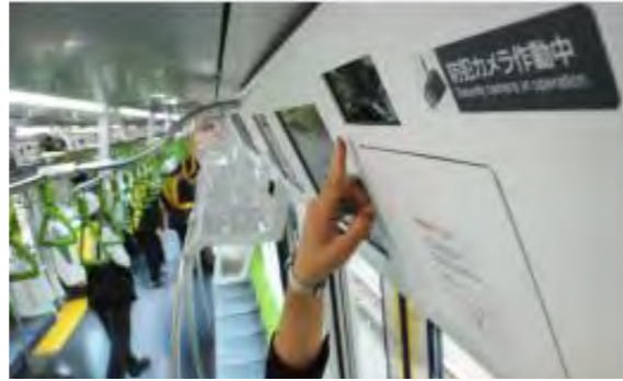
山手線の車両内に設置された防犯カメラ
